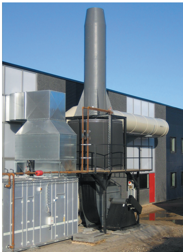
Förnicklingsindustri med värmewäxlare CWX 11 och radialfläkt LCPS 100. Skorsten av GAP.
