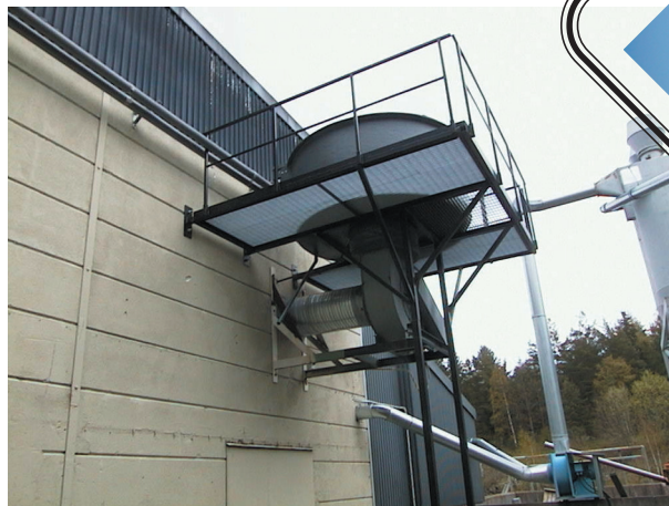
Värmeväxlare CWX 06 vid utsug från lackbox i möbelindustri.
