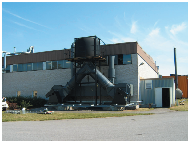
Ytbehandlingsindustri inom flygvapnet med värmewäxlare CWX 11 och två radialfläktar LCPB 90.
